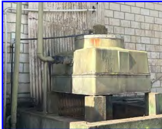
LOTE M49 – TORRE DE RESFRIAMENTO ACOMPANHA TUBULAÇÃO
